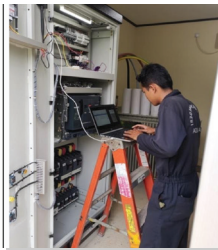
Pengecekan jarak jangkauan sinyal dan implementasi modul pada gardu listrik
